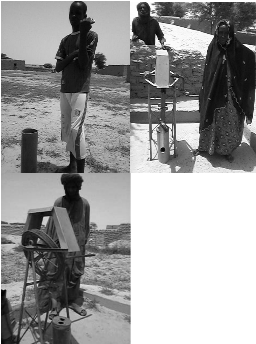
Figure 4: (a) Point d'eau à Temera, Forage manuel dont la Pompe à Corde est emporté et vandalisée (gauche); (b) Point d'eau à Temera, Pompe à Corde dont la corde et les roulements sont cassée (milieu), Point d'eau à Bamba, Pompe à Corde vandalisée (gauche)
